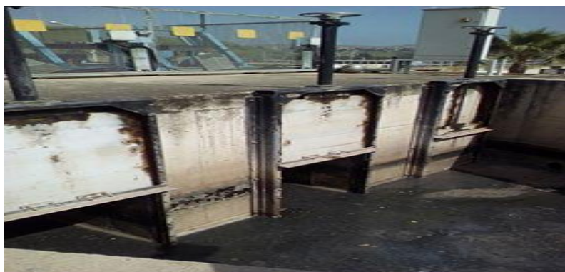
Figure 6 : Canaux d'entrées de l'eau usée au criblage grossier, avec des ouvertures manuelles.
