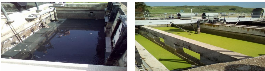
Figure 8 : Séparation du sable et de la graisse.
