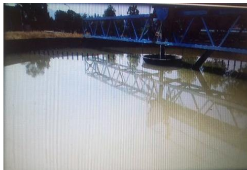
Figure 14 : Bassins d'assainissement des boues activées.
