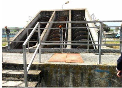
Figure 13 : Photo de refoulement des boues activées par les pompes à vis.
